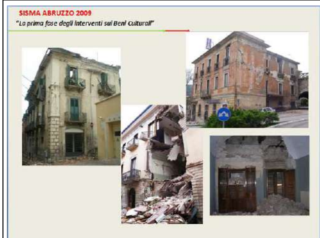
Fig. 54 - ribaltamento delle fasce sottotetto e rottura a flessione alle pareti
