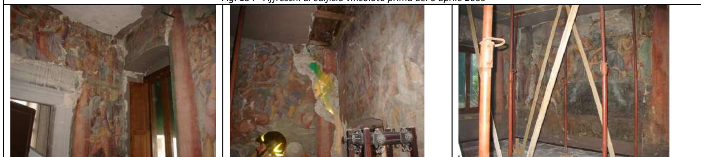
Fig. 135 - Affreschi di edificio vincolato dopo il 6 aprile 2009
