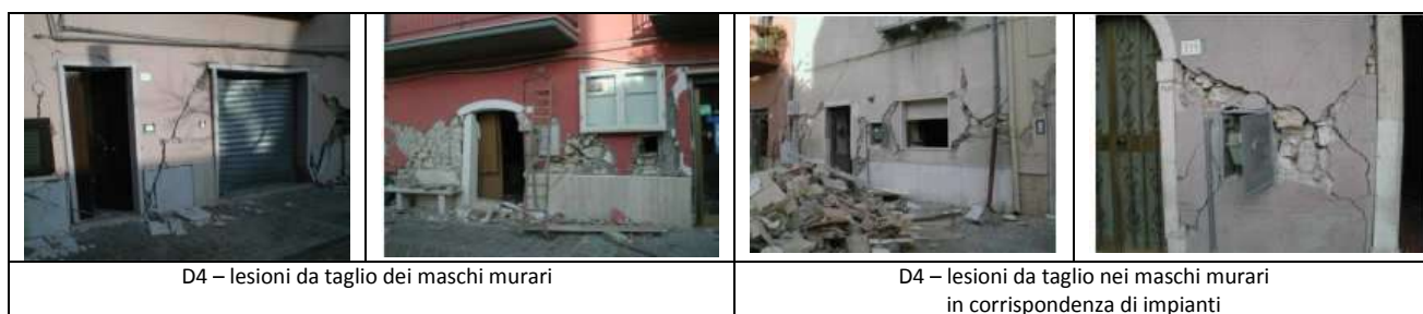
Fig. 73 – danni accentuati dalla presenza di aperture per impianti
