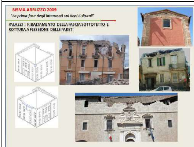
Fig. 52 - ribaltamento della fascia sottotetto e rottura a flessione alle pareti
