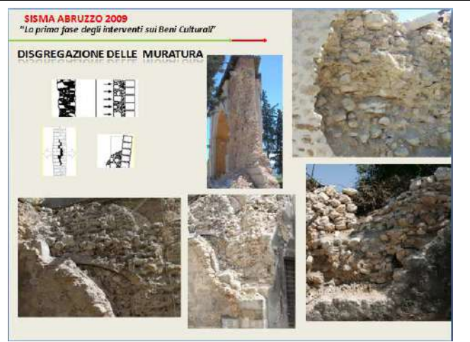
Fig. 55 - Disgregazione della muratura
