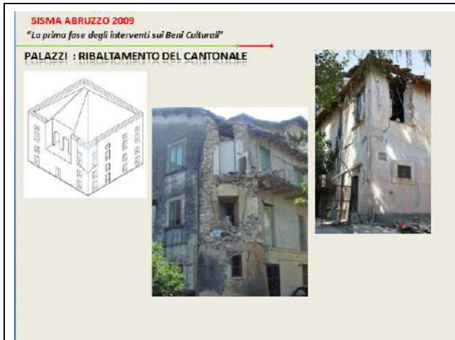
Fig. 50 - ribaltamento del cantonale
