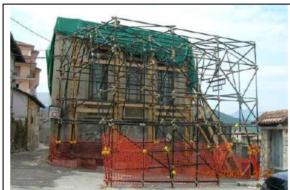
Fig. 182- Foto del esterno del edificio danneggiato dal sisma del 2009
