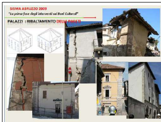
Fig. 48 - ribaltamento delle pareti
